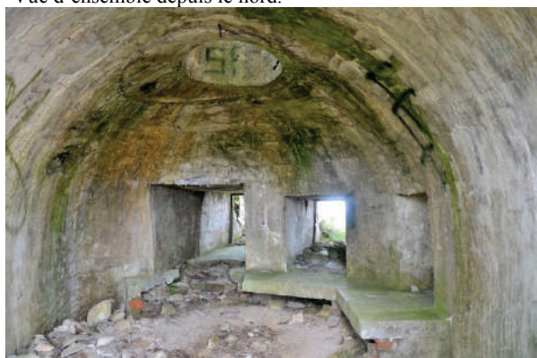
Le poste optique.
